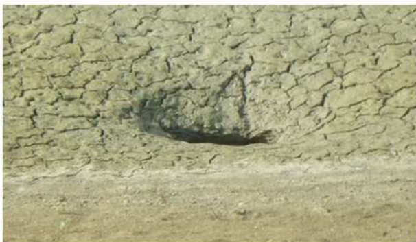
uno dei buchi rilevati sul fondo del lago, probabilmente provocati dalla contropressione di risalita della falda
